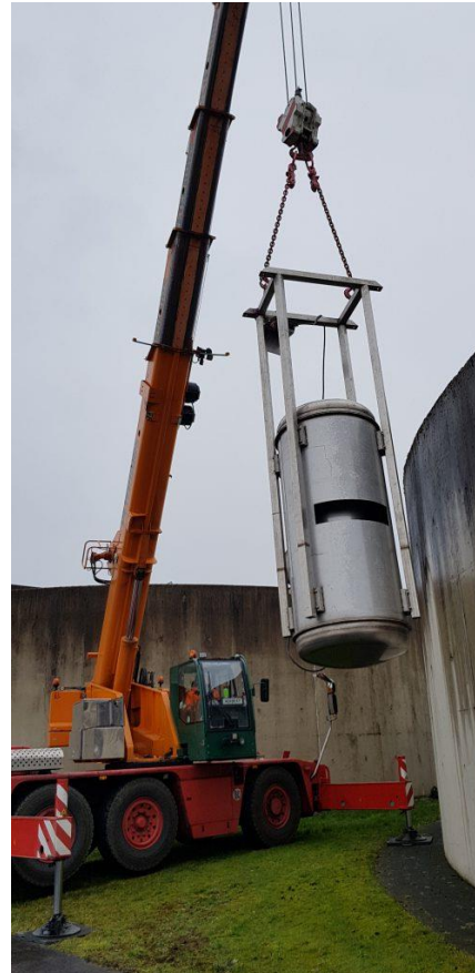
Abb. 3 Der FlocPhos auf der KA Gürersloh
