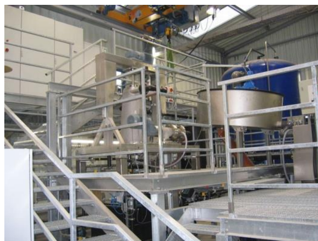
Deponiesickerwasserreinigung mit FlocFormer+ 2L
